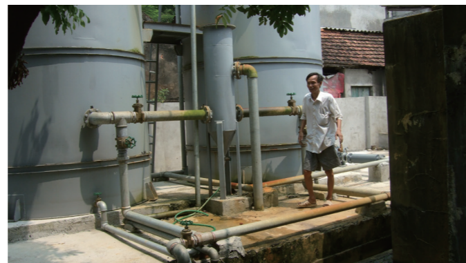
ベトナムに設置した地下水処理施設
